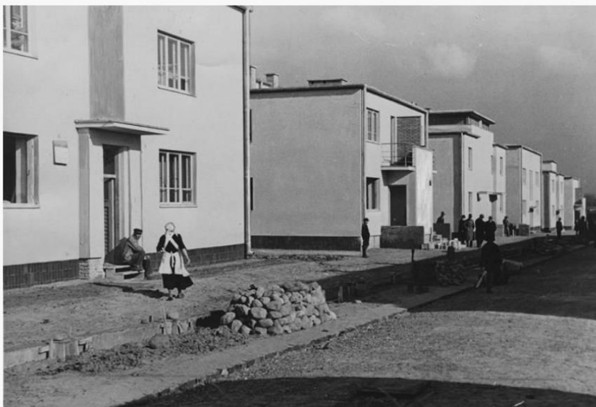
Budowa osiedla Banku Gospodarstwa Krajowego na Kole w Warszawie, 1934, fot. www.audiovis.nac.gov.pl (NAC)
